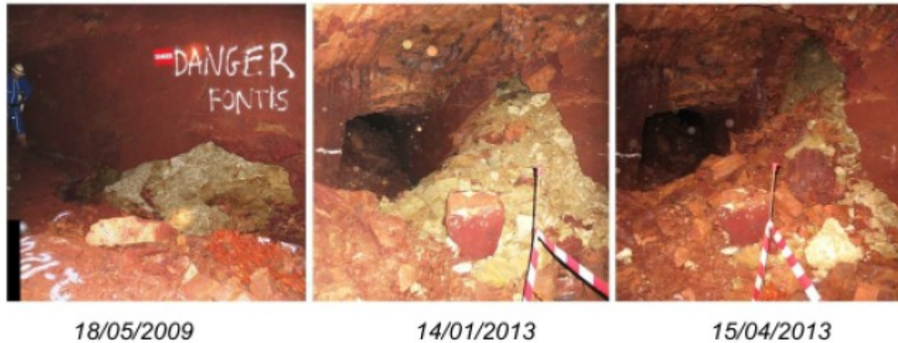
Evolution de la dégradation du mur cote 1045
