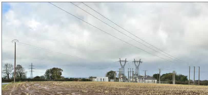
Le poste Caumont existant vu depuis l'angle sud-est sur la D71
