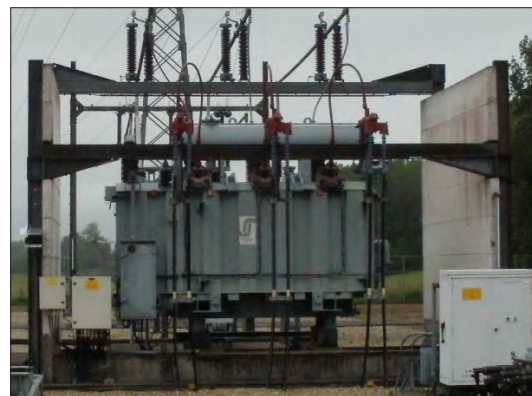
Un transformateur 90 000/20 000 volts et ses murs pare-feu
