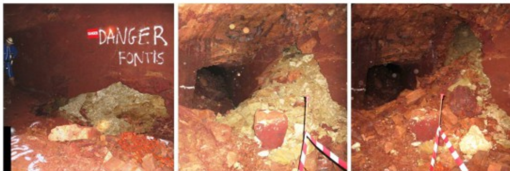
Evolution de la dégradation du mur cote 1045
