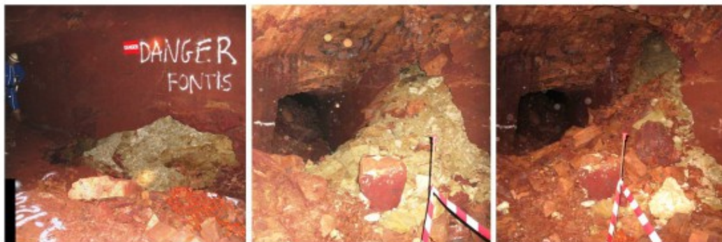
Evolution de la dégradation du mur cote 1045
