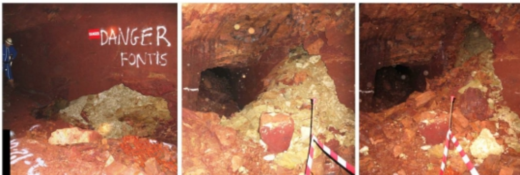
Evolution de la dégradation du mur cote 1045
