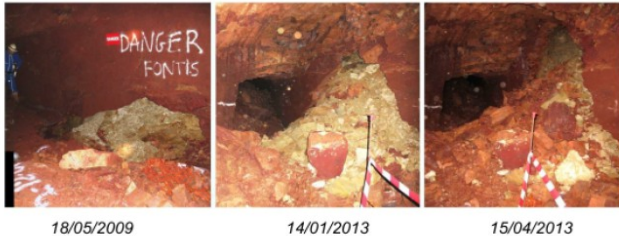
Evolution de la dégradation du mur cote 1045
