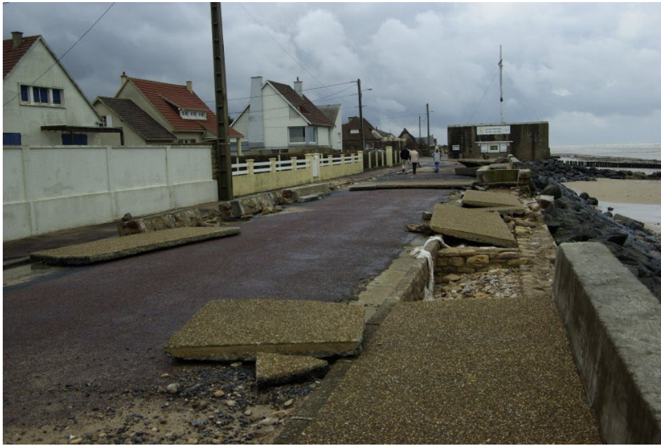
Figure III.43: Endommagement du revêtements de la digue par les paquets de mer, lors de la tempête Xynthia, février 2010 (source : DDTM Bayeux).
