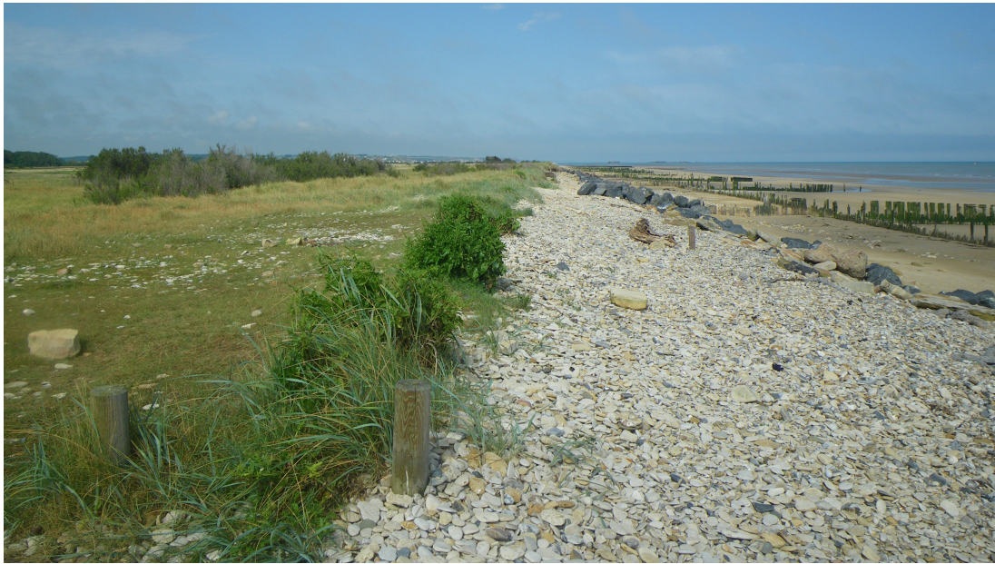
Figure III.49: Aspect de l'enrochement au Pont Chaussé à Ver-sur-Mer. Faible altimétrie de l'enrochement et signes de franchissement par la mer assez fréquent : plage à galets en crête d'ouvrage et ligne de végétation poussée en arrière (photo AGR & IMDC, 2013).
