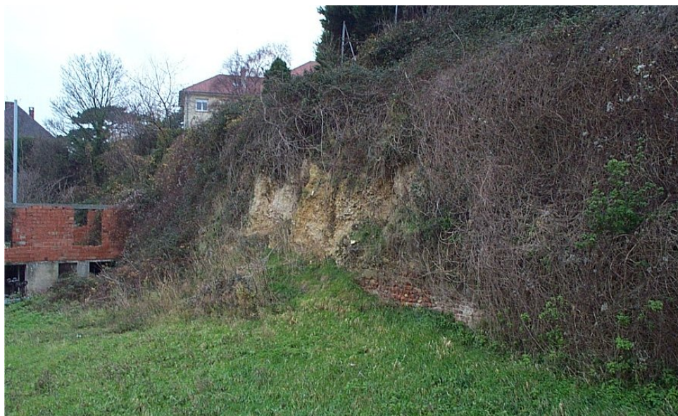
Figure n°15 : photographie d'un ancien front de taille de carrière à ciel ouvert (exploitation de calcaire), affecté par des instabilités superficielles, rue Berthier à Trouville-sur-Mer.
