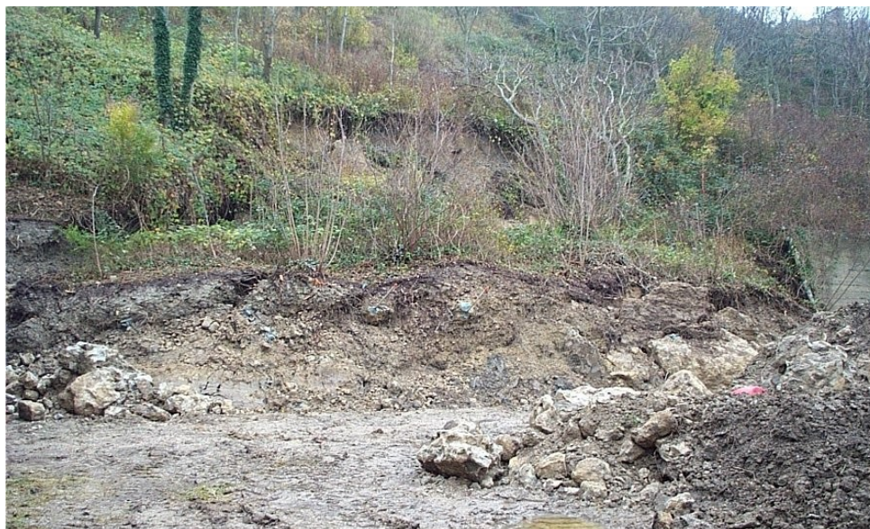
Figure n°6 : photographie d'un glissement de talus en pied du versant côtier boulevard Breguet à Trouville-sur-Mer le 30 novembre 2005.
