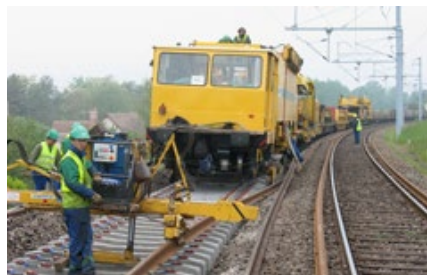
Longs Rails soudés sur traverses béton
