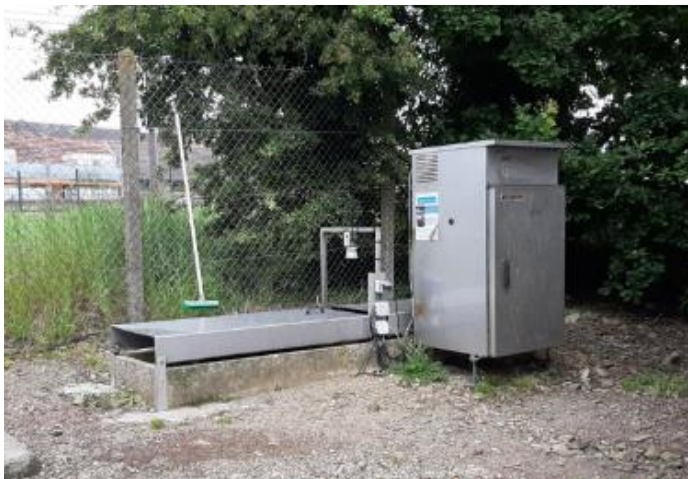
Canal de comptage sortie
