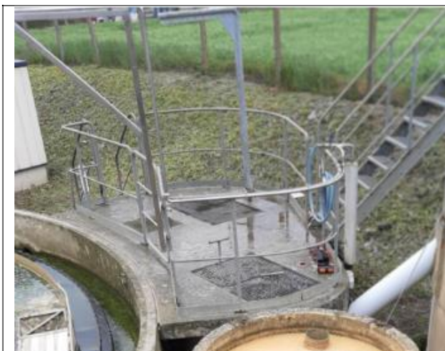
Poste de recirculation
