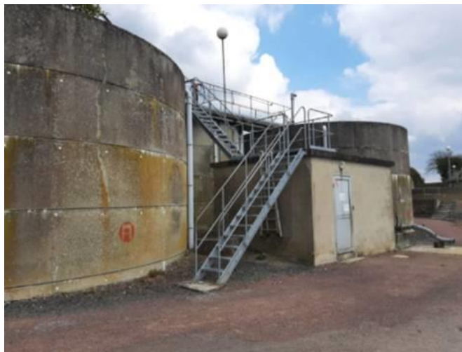
Silos à boues existants (2 x 370 m 3 )
