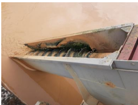
Vis de vidange bassin d'aération
