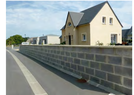
☹️ Muret de clôture non enduit
