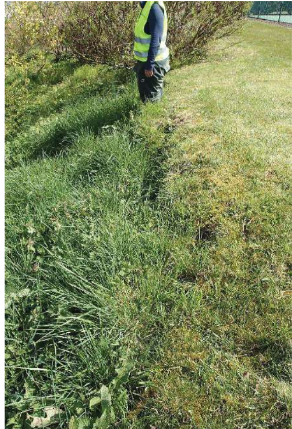
Figure 24 : Fracture ouverte au sol, d'un rejet vertical d'environ 50 cm pour 30 cm de rejet horizontal, côté nord du terrain de tennis sur la parcelle 0779 (n°80).
