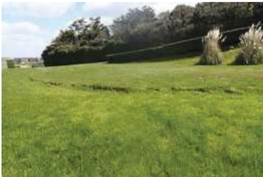
Figure 3 : Fissure au sol NE-SW d'environ 70 m de longueur, en contrebas du n°70.
