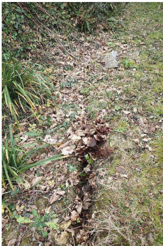
Figure 33 : Fissure ouverte d'environ 15 cm observée sur un cheminement piétonnier en parcelle 1050 (n°82).
