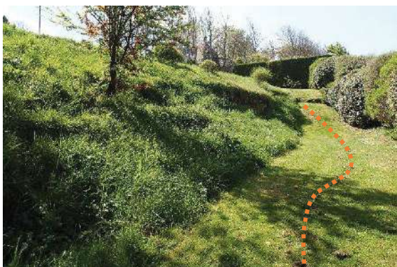
Figure 26 : Fissure au sol d'environ 25 m linéaires sur le cheminement piétonnier de la parcelle 0779 (n°80).
