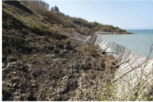
Figure 10 : Ganivelles couchées en pied du glissement de terrain observé au droit de la propriété du n°80.
