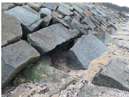
Figure 62 : Blocs désolidarisés observés en pied des enrochements au droit de la parcelle 0168 (n°70) en décembre 2021.
