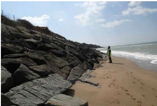
Figure 5 : Enrochements déformés au droit de la propriété du n°70.
