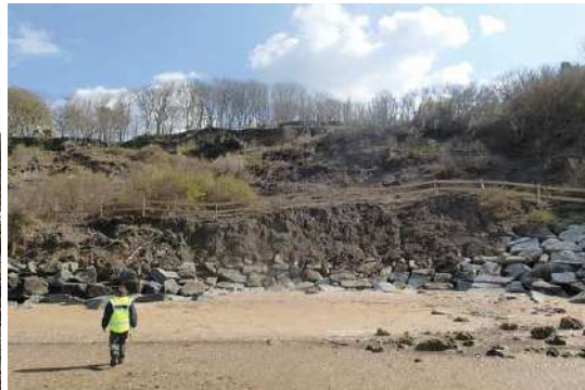
Figure 14 : Talus et enrochements recouverts au droit des n°82 et 96.
