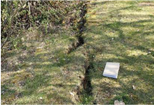
Figure 9 : Fissure au sol ouverte présentant un rejet horizontal d'environ 10 cm en contrebas de la propriété du n°80.
