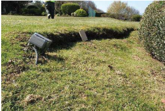
Figure 23 : Fracture au sol d'un rejet vertical d'environ 20 cm sur la parcelle 1030 (n°80) avec tassement côté nord sur environ 1 mètre de hauteur.
