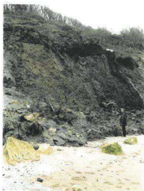
Figure 75 : Pied de falaise au droit des parcelles du n°82 dans les marnes en place en 2000 ; à la base, accumulation de matériaux divers glissés avec localement de petites coulées bouseuses ; au sommet, la ligne continue sombre correspond à une surface de glissement (cliché Olivier Maquaire, 2000).
