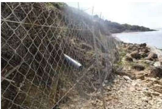
Figure 7 : Drain de rejet de l'excédent d'eaux pluviales de la propriété du n°70.
