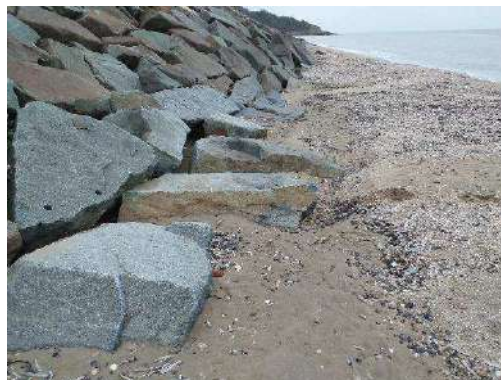
Figure 61 : Affouillement vu en décembre 2021 à la base des enrochements devant la parcelle 0168 (n°70).
