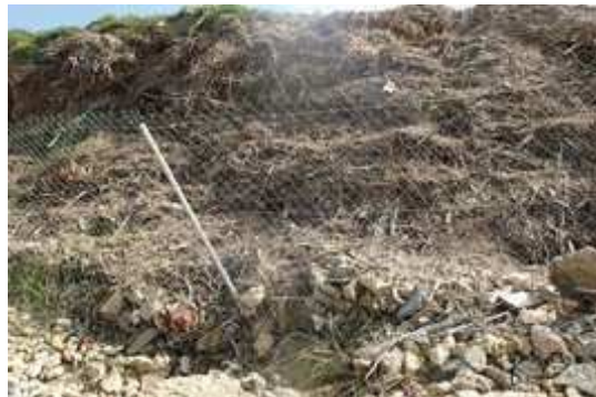
Figure 6 : Talus en front de mer, au-dessus des enrochements, devant la propriété n°70.
