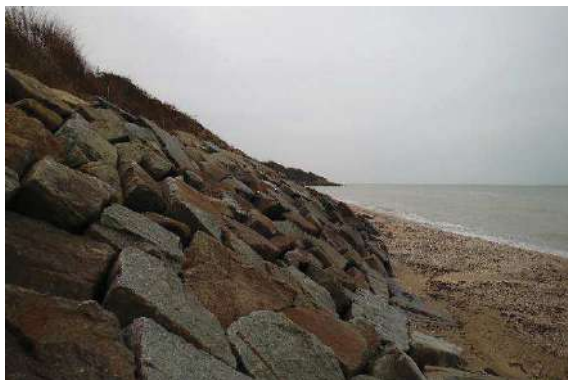
Figure 60 : Bombement des enrochements au droit de la parcelle 0168 (n°70).
