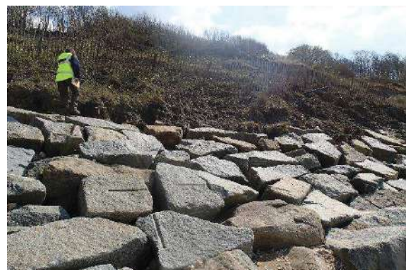
Figure 59 : Enrochements au droit de la parcelle 1030 (n°80) en avril 2021.
