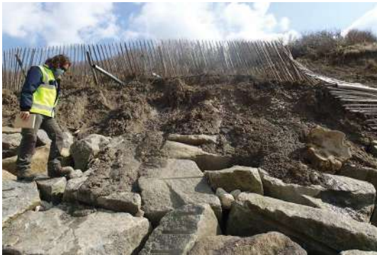
Figure 11 : Enrochements partiellement recouverts par les terrains glissés au droit de la propriété du n°80.
