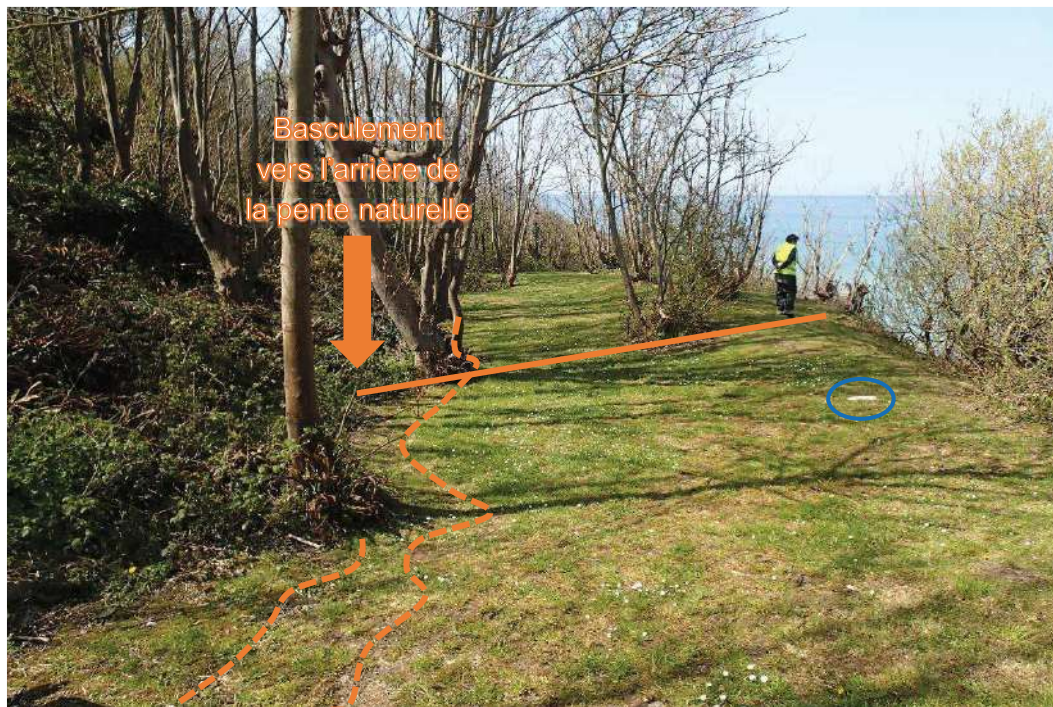
Figure 28 : Affaissement général vers l'arrière de la pente naturelle, en contrebas de la parcelle 0779 (n°80), morphologie typique d'un basculement en tête de glissement rotationnel ; en pointillés orange, des fissures sont visibles au sol (repère visuel pour faire le lien avec la figure 30 par la petite plaque béton entourée en bleu).
