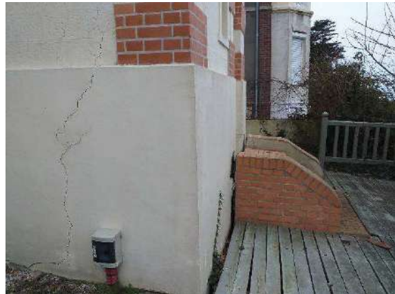
Figure 51 : Fissure, escalier décollé et terrasse affaissée, façade nord de la maison de gardien de la propriété du n°96 (parcelle 0035).
