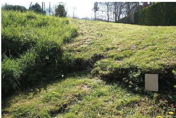
Figure 25 : Fracture au sol de 25 cm de rejet vertical et départ perpendiculairement d'une fissure sur environ 25 m linéaires, visibles dans la descente côté nord du terrain de tennis sur la parcelle 0779 (n°80).
