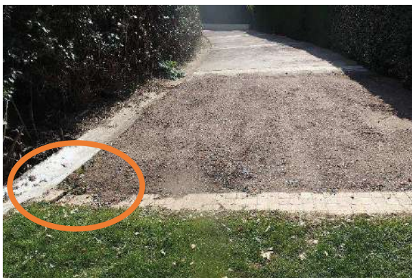
Figure 21 : Allée piétonne remblayée, zone affaissée et réparée entourée en orange ; la photo 22 a été prise dans les bambous jouxtant cette zone.
