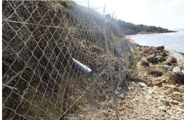
Figure 57 : Exutoire d'un drain de la parcelle 0168 au-dessus des enrochements littoraux.
