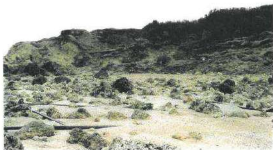
Figure 73 : Pied de falaise au droit de la parcelle 0035 en 2000 ; la morphologie générale est typique des contre-pentes avec des escarpements vifs où sont observés des marnes et des formations de pente très hétérogènes ; le haut de la plage est parsemé de blocs de « Coral-rag » et des blocs calcaires sont présents sur l'estran (cliché Olivier Maquaire, 2000).
