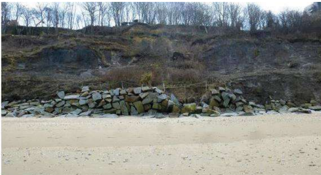
Figure 77 : Enrochement partiellement détruit par le glissement de terrain actif au droit des parcelles du numéro 82, dans l'anse de Bénerville (cliché Nathan Savary, 2015 ; in Cerema, 2019).
