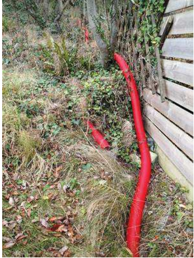
Figure 44 : Canalisations en surface avec évacuation dans le terrain, en limite de parcelles 1050/1049 (n°82).
