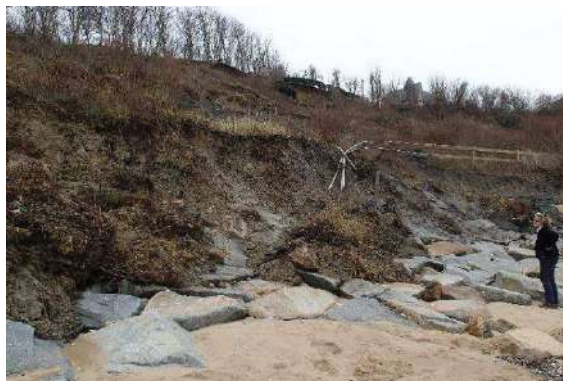
Figure 70 : Les terrains marneux ont glissé et emporté la barrière de limite de propriété en décembre 2021.
