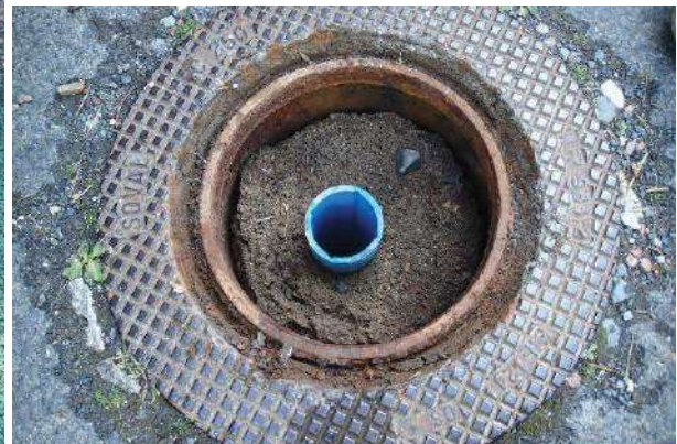
Figure 6 : État du tube I2 à l'ouverture.
