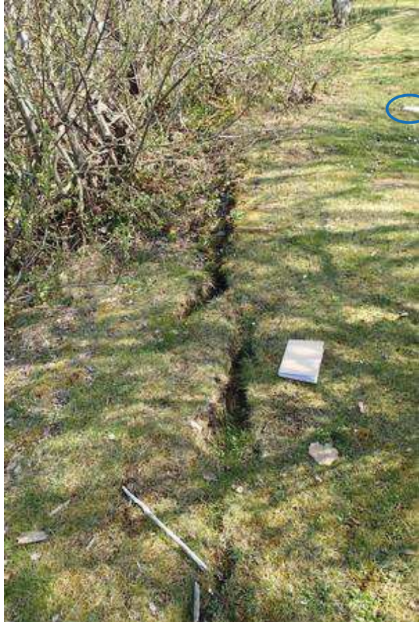
Figure 30 : Fissure au sol ouverte présentant un rejet horizontal d'environ 10 cm, parallèle au basculement observé en contrebas de la parcelle 0779 (n°80) (repère visuel pour faire le lien avec la figure 28 par la petite plaque béton entourée en bleu).
