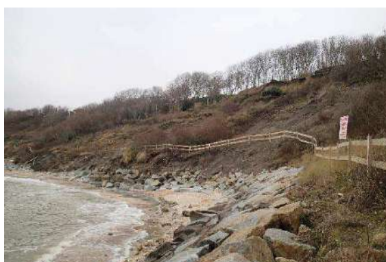
Figure 72 : Parcelles 1000 et 0999 en décembre 2021 ; les terrains marneux ont glissé en partie centrale mais la barrière bois est toujours en place.
