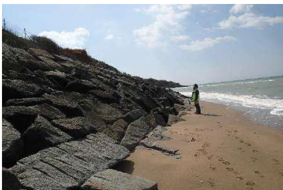
Figure 58 : Enrochements au droit de la propriété du n°70 (parcelles 0168 et 1031) en avril 2021.
