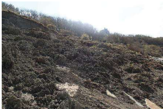
Figure 54 : Enrochements recouverts par les terrains glissés au droit de la parcelle 1050 (n°82).
