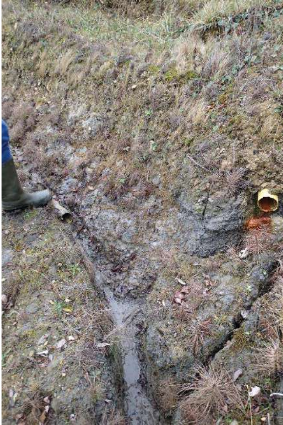
Figure 43 : Sillon et canalisations endommagées en parcelle 1050 (n°82).
