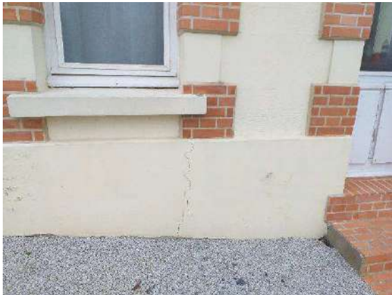
Figure 50 : Fissures en façade est de la maison de gardien de la propriété du n°96 (parcelle 0035).
