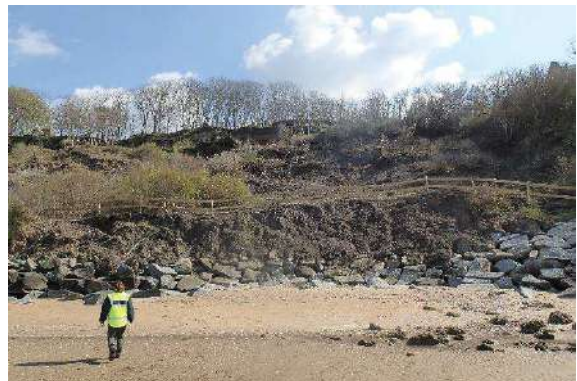
Figure 55 : Talus et enrochements recouverts par les terrains glissés au droit des parcelles 1049, 1000 (n°82) et 0999 (n°96) ; à gauche de l'image, les enrochements sont désorganisés.
