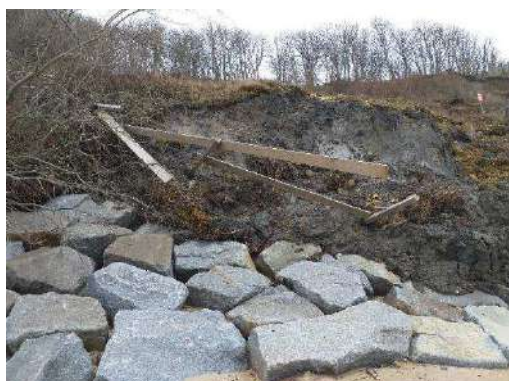
Figure 69 : État de la barrière en décembre 2021 en limite des parcelles 1049 et 1050 (n°82).
