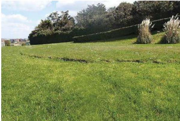
Figure 19 : Fissure au sol NE-SW d'environ 70 mètres linéaires en partie basse de la parcelle 1031 (n°70).
