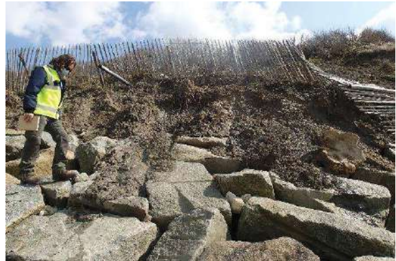
Figure 53 : Ganivelles couchées et enrochements partiellement recouverts par les terrains glissés au droit de la parcelle 0779 (n°80).
