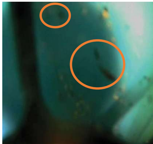
Figure 13 : Tube I1 à - 21 m après nettoyage ; les salissures sont encore présentes et des particules en suspension sont visibles (entourées en orange).
