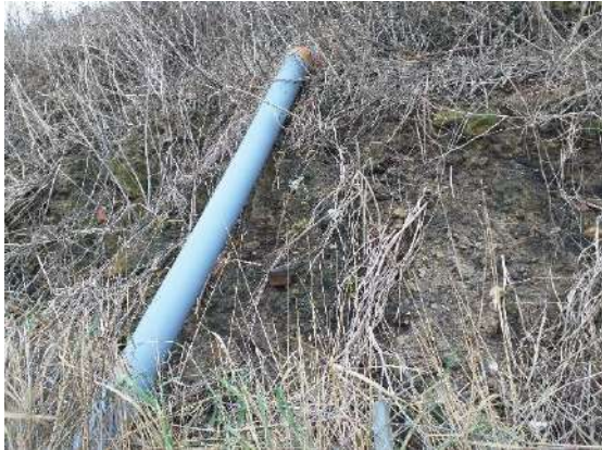
Figure 56 : Drain issu de la parcelle 0168 dont l'évacuation n'est pas visible (sous les enrochements).
