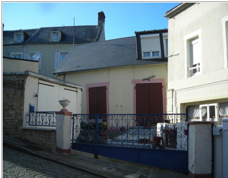
Figure 11: Une maison située au 4 rue du phare présentait d'importants signes d'affaissement : « la maison qui penche » (photo d'avril 2011). Son pignon ouest portait sur un sol mou pouvant correspondre à des vases marines. Cette maison a été depuis démolie.
