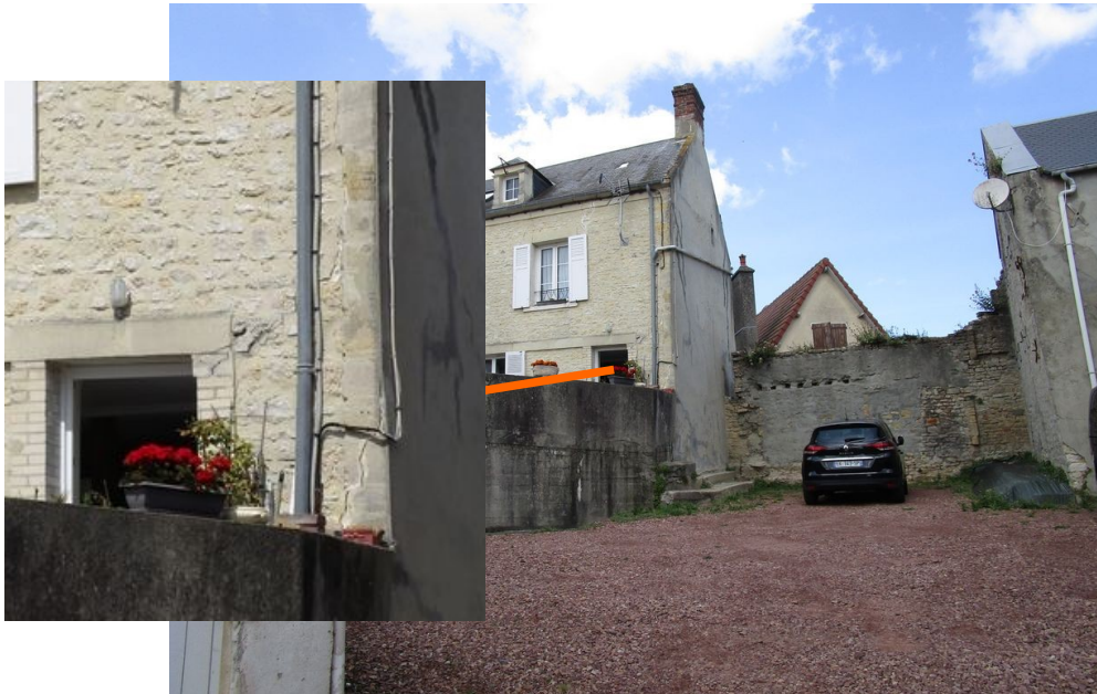
Figure 12: ancien emplacement de la "maison qui penche" devenu un parking (photo de juin 2023). En arrière plan deux constructions sont sévèrement fissurées.
