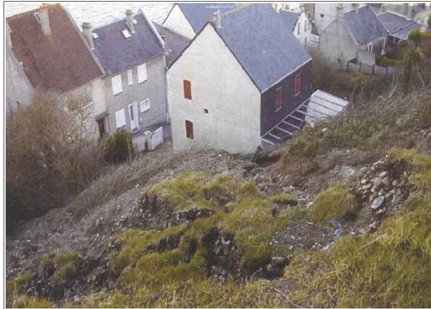
Figure 7: ravinement et glissement de terrain de 1999 entre les rues du Phare et Torteron ; le phénomène s'est calé contre une maison de la rue Torteron.
