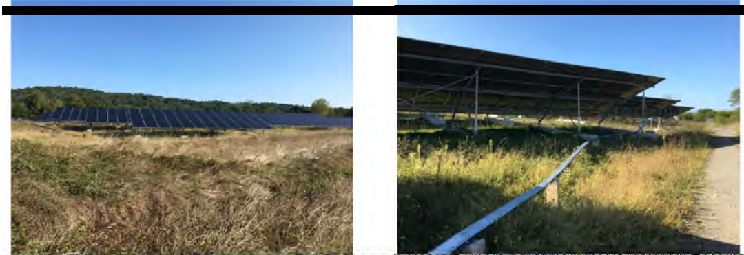
Figure 2 : Parc photovoltaïque de Clarac (31)
